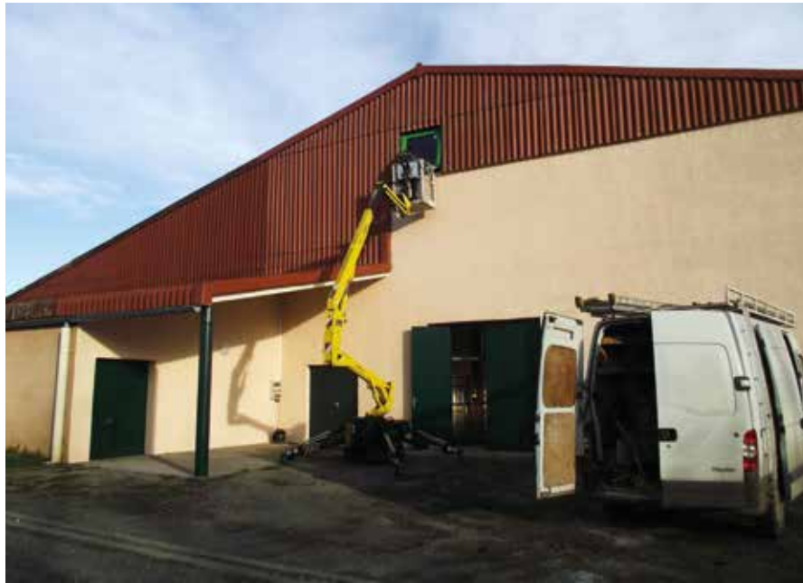
Remise en état de la salle polyvalente due à l'incendie volontaire.
