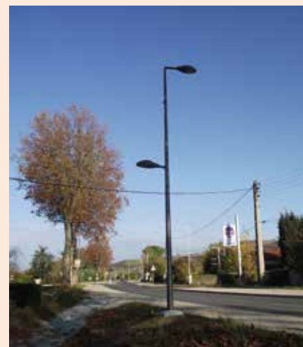
Les nouveaux réverbères de l'éclairage public route de Toulouse..
