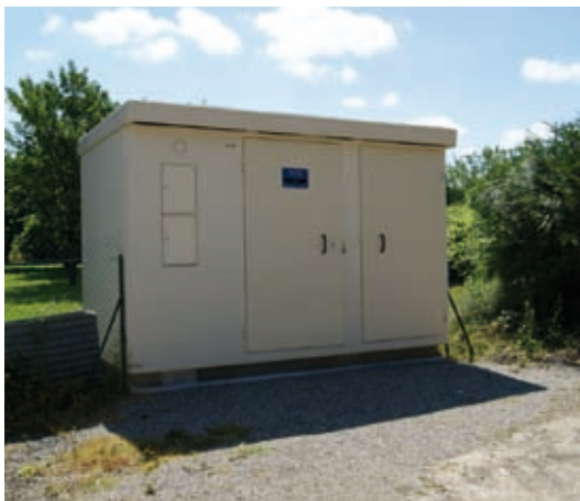
Transformateur du hameau de Capitany
